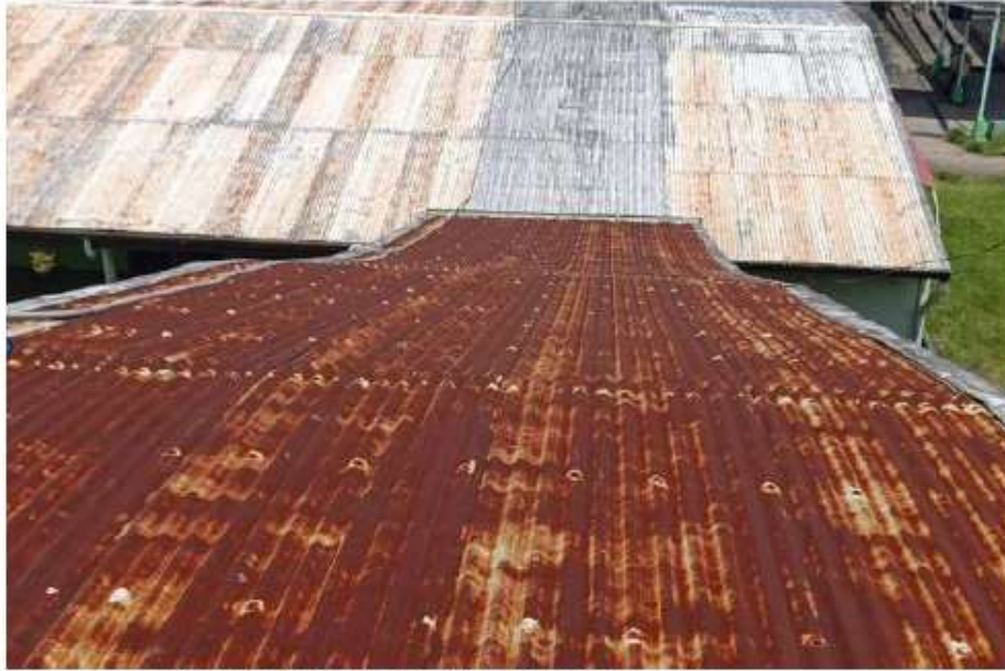
Imagen No 2 Estado actual del zinc del pasillo.
