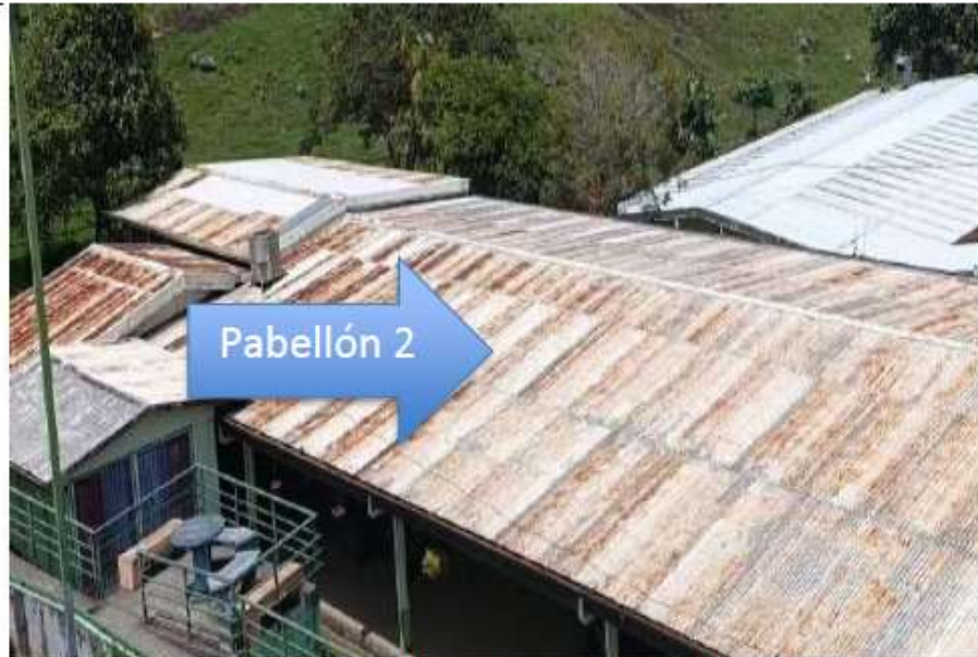
Imagen No 3 Estado actual del zinc pabellón 2
