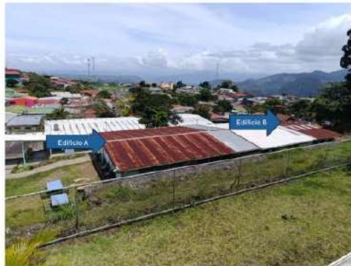
Imagen No 5 Estado actual del zinc pabellón 3
