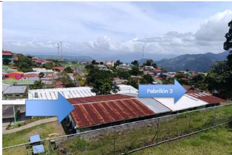
Imagen No 4 Estado actual del zinc pabellón 3
