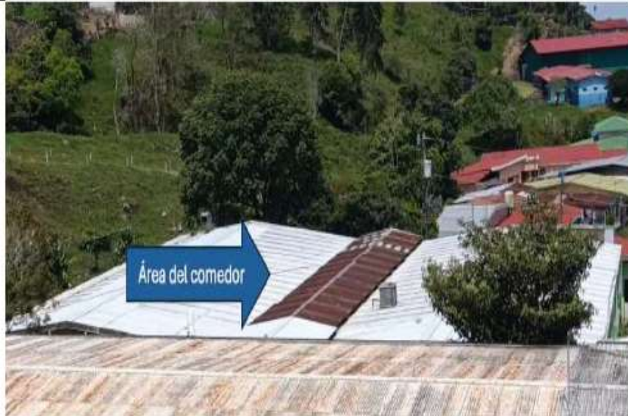
Imagen No 5 Estado actual del zinc pabellón 4
